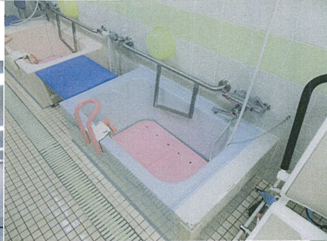
入浴実習設備
